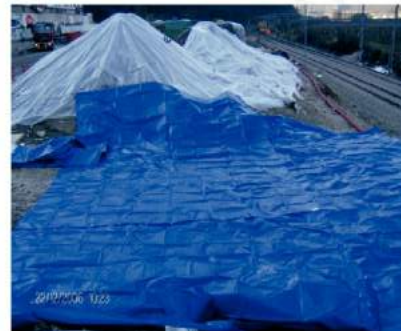
MESSA IN SICUREZZA D'URGENZA F.S. Sinistro del 13/12/2006, Borghetto - Avio (Tn)
