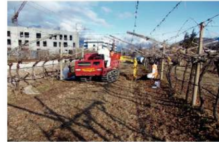
Comune di Trento Bonifica area a seguito di sversamento di gasolio
